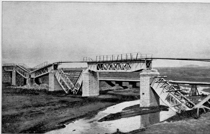
Разрушенный ж. д. мостъ.
