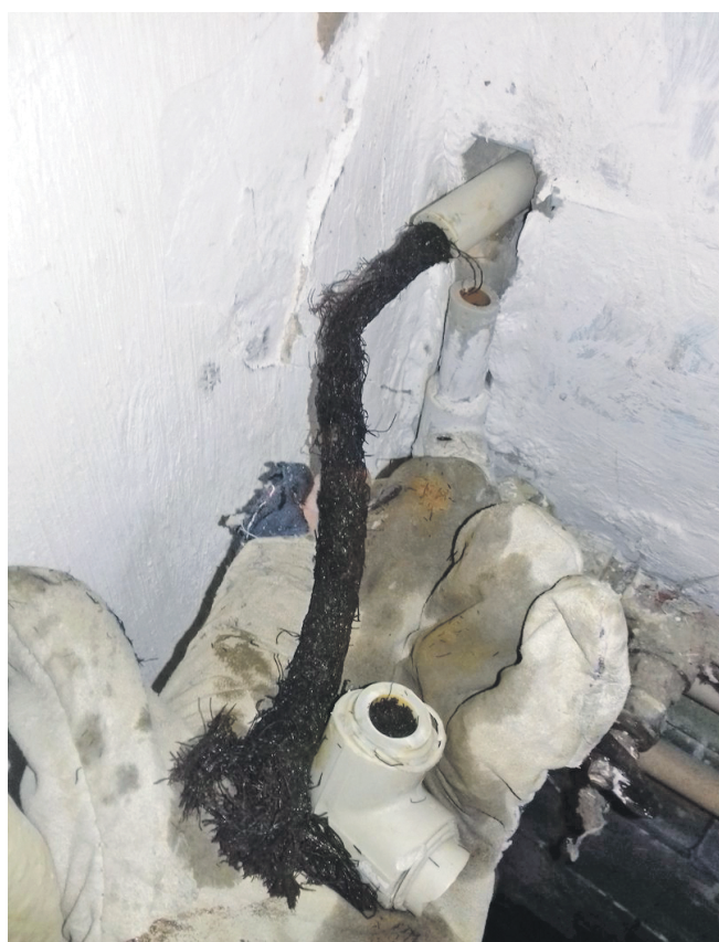
Ось так морська вода з водоростями просочується до водогонів Красноперекопська
