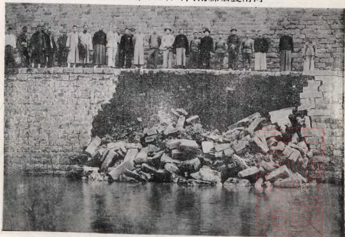
河南襄城縣南門外石堤坍塌情形之二
