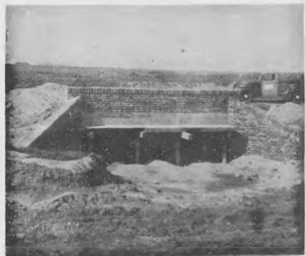
Camino Coronel Vidal - Balcarce. Alcantarilla: luz 4m.
