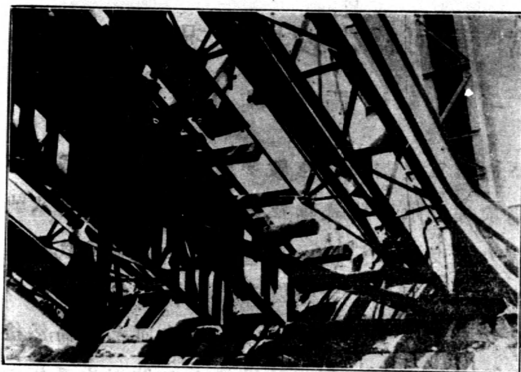
照片二. 向北看之第八號毀壞橋墩
