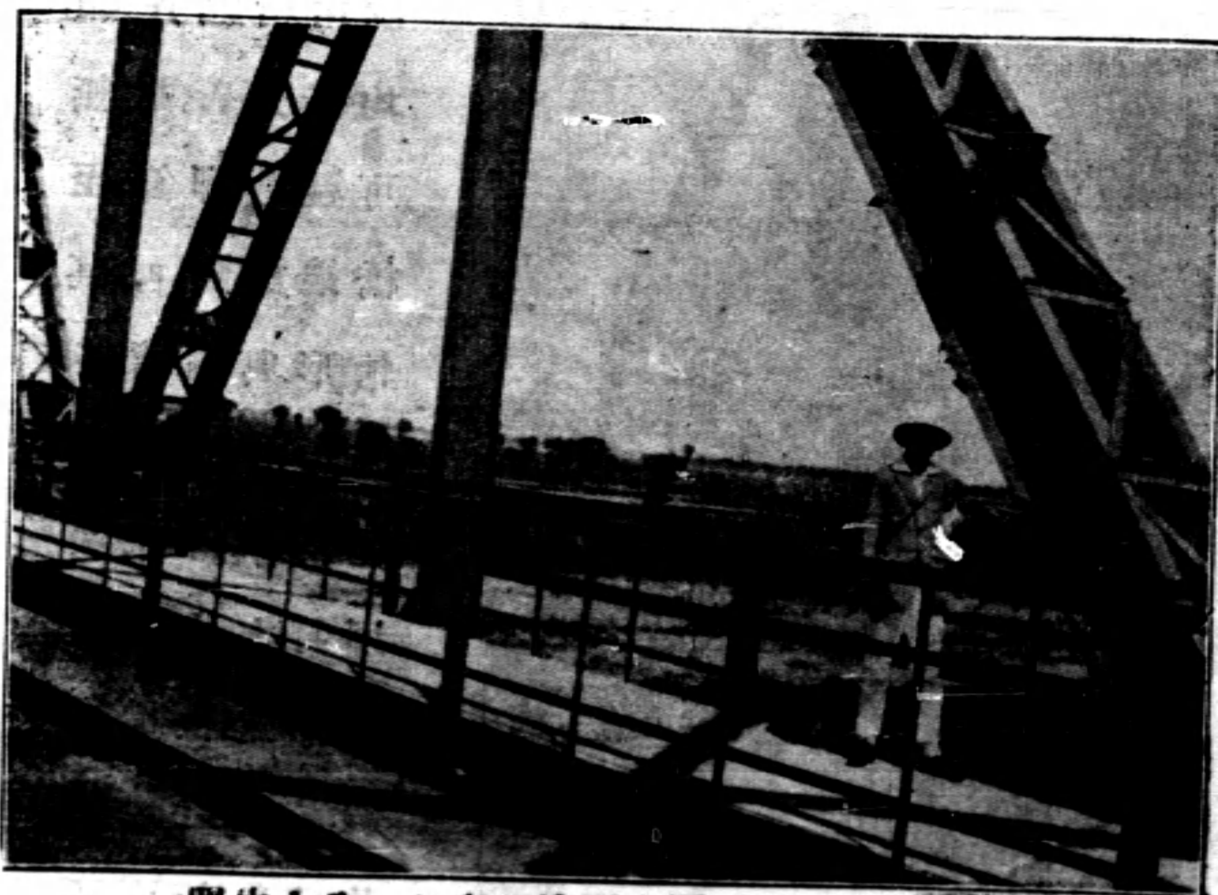
照片十八. 向東看第四空單式橋之毀壞斜撐
