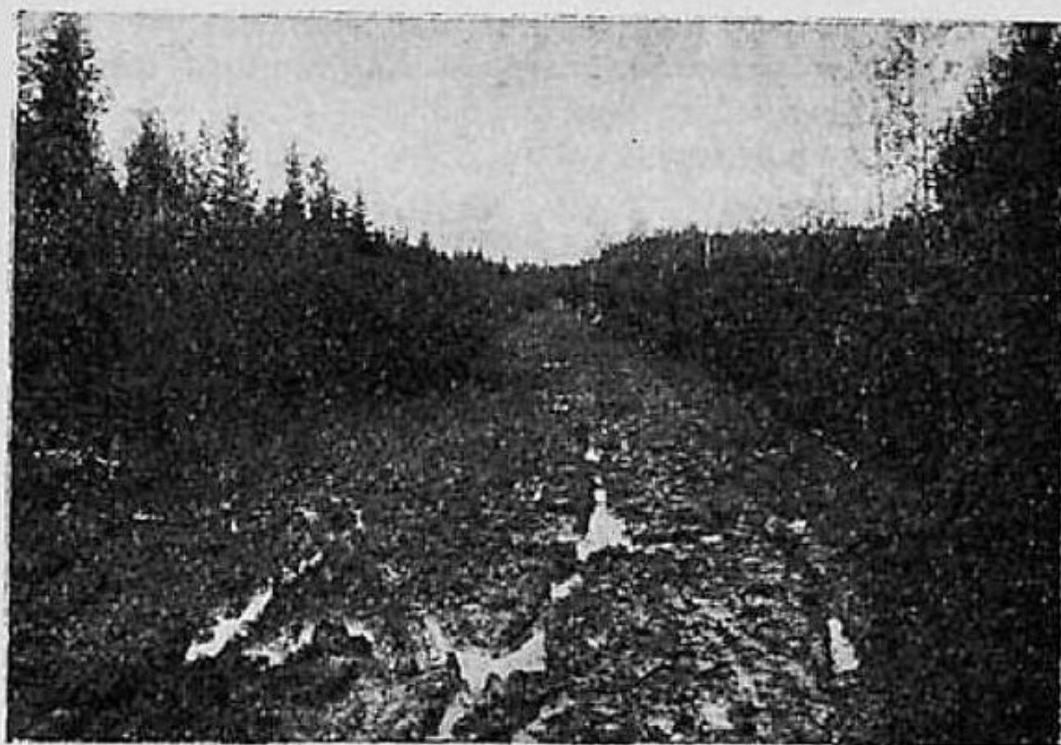
Общий вид деревенской дороги. Густые заросли поглощают полотно дороги.
