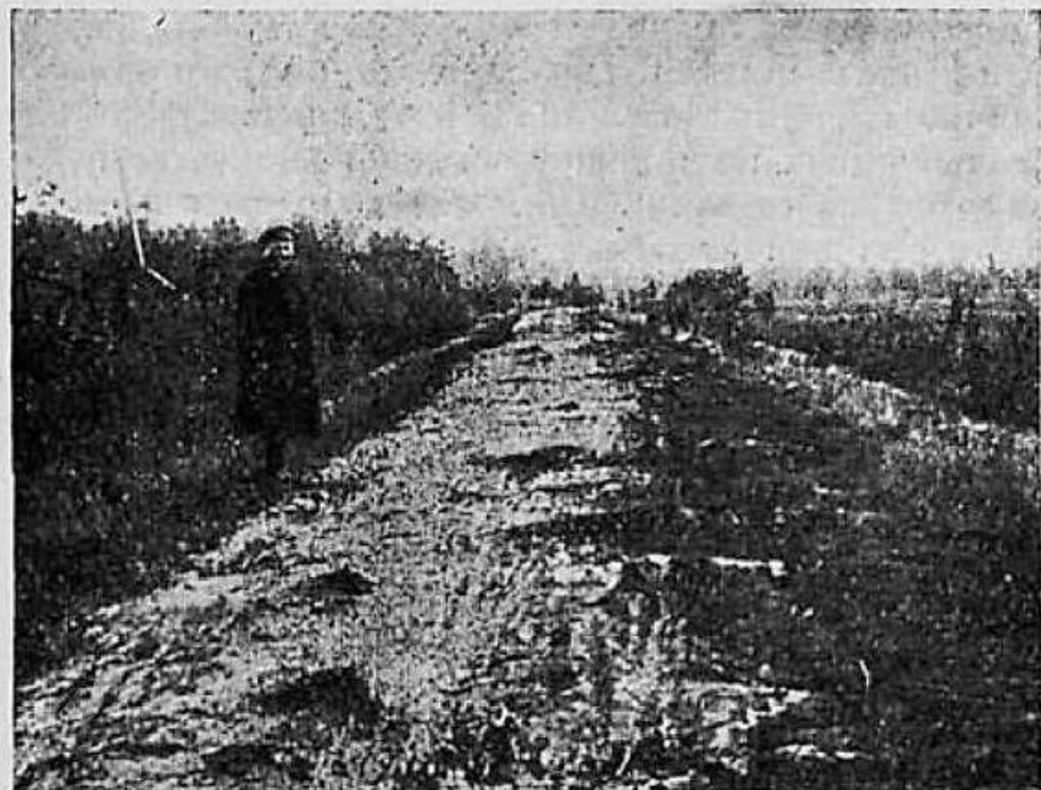
Дорога, идущая по болотам, требует неустанных забот. На полотне дороги выступают ранее уложенные бревна. Население должно объезжать эту дорогу, неся значительные убытки.
