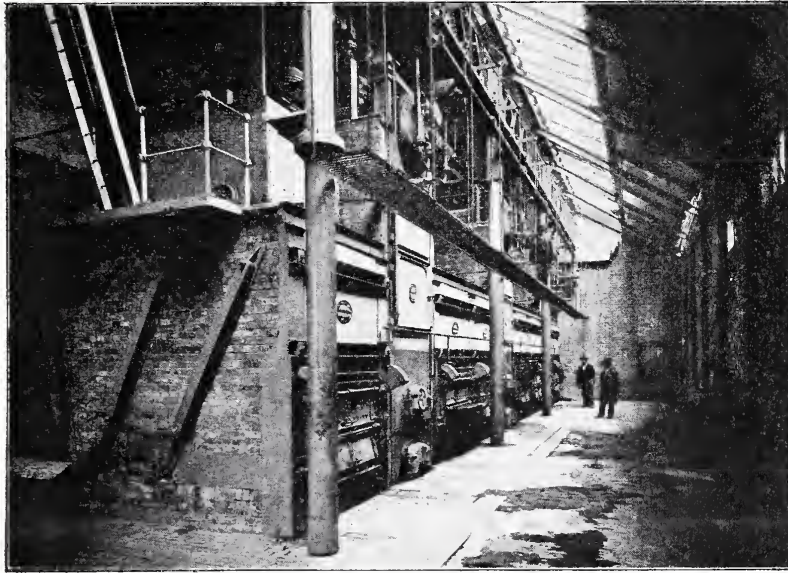
Abb. 3. Müllverbrennungszellen und Dampfkessel.
