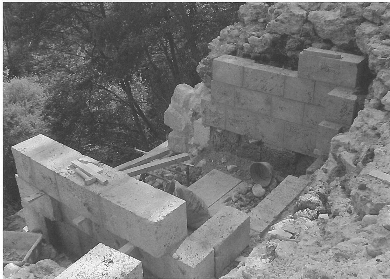
Die Tuffsteinauskleidung der Tankzisterne wird dreiseitig rekonstruiert, wobei Lage und Grösse der Blöcke den im Mauerwerk noch vorhandenen Resten entsprechen.
