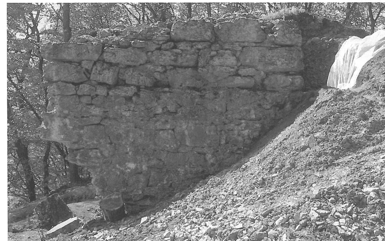
Ansicht der östlichen Turmmauer. Gut erkennbar die horizontale Trennlinie zwischen dem unteren, in Grube gemauerten Turmfundament und dem auf Sicht gemauerten aufgehenden Mauerwerk.
