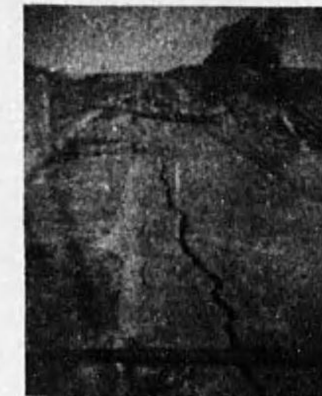
第6 日和佐町築堤のすれ込みに依る龜裂
