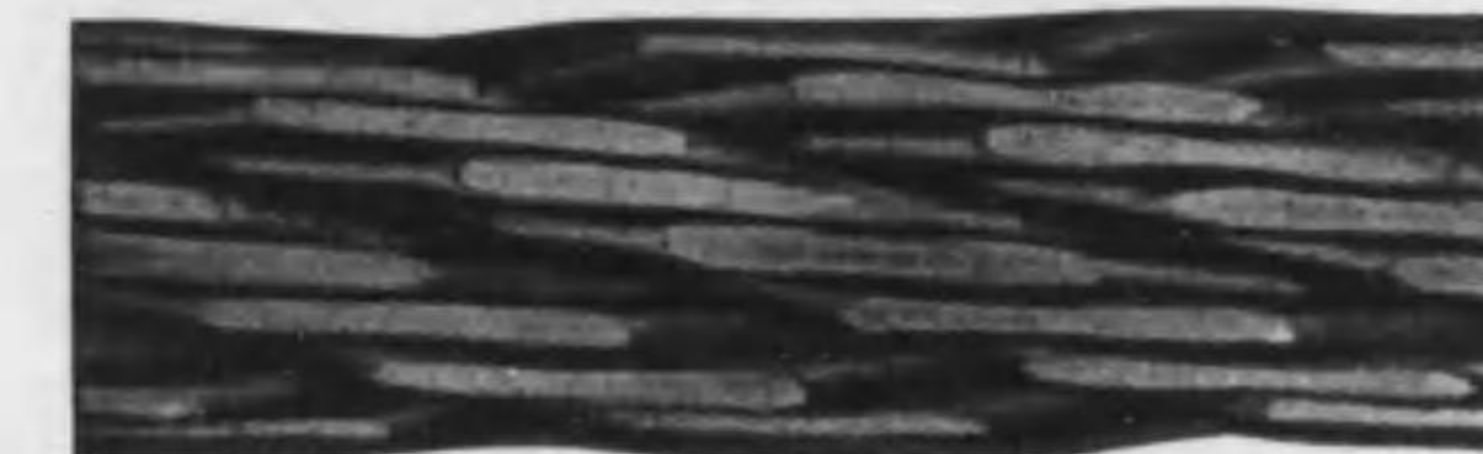
同上 摩損状態
