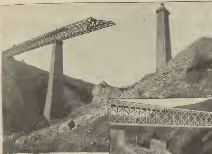
FERROCARRIL DE LINARES A ALMERÍA. — EL VIADUCTO DEL SALADO. — OPERACIÓN DE CORRER UNO DE LOS TRAMOS DEL PUENTE SOBRE LAS PILASTRAS (de fotografía de López, de Baeza).
