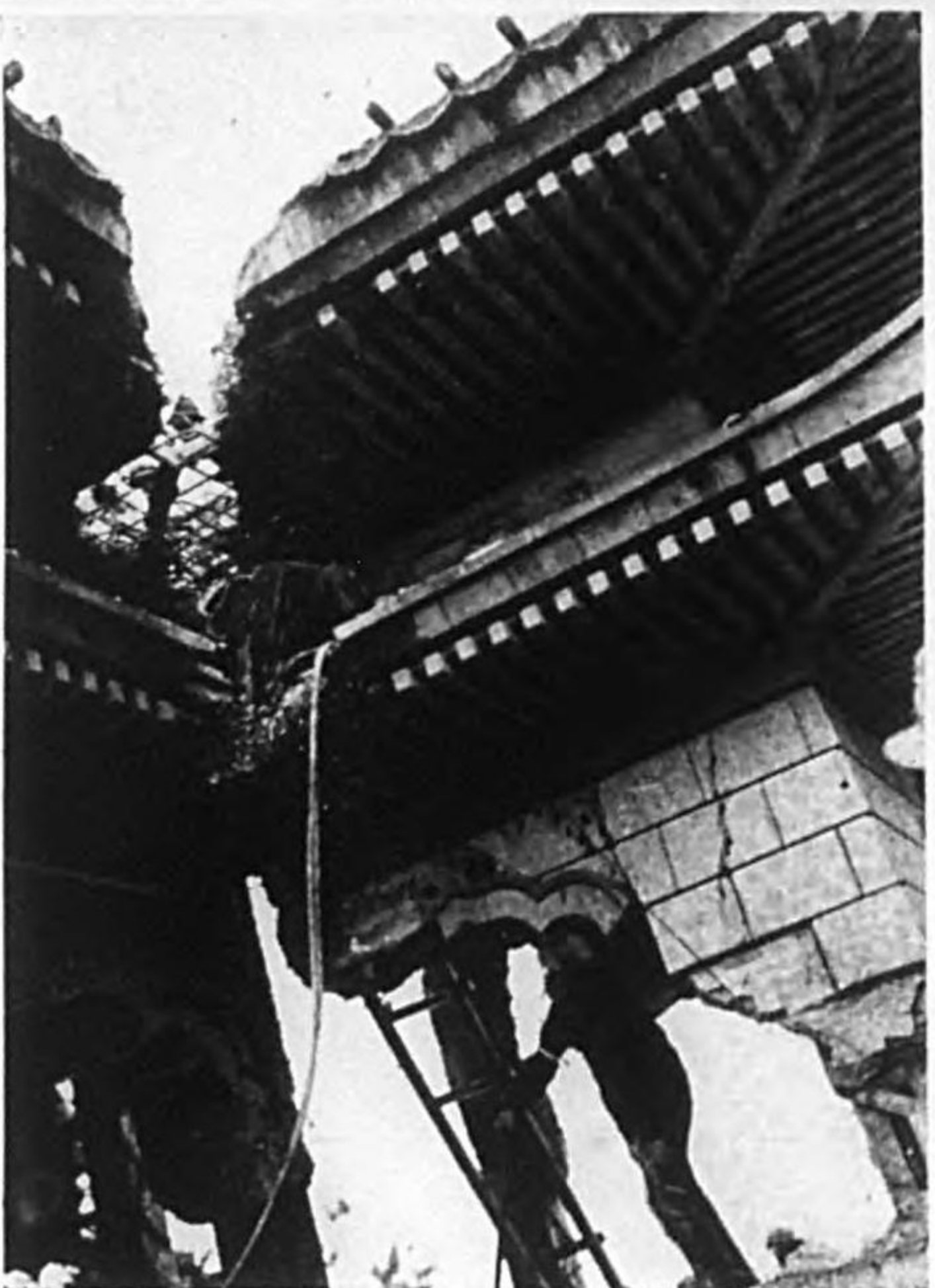
破却工事中の月宮殿の一部 鐵骨鐵筋を酸素瓦斯にて切断しつゝあるを示す
