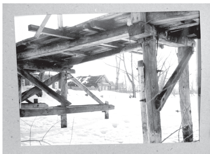
Полуразрушенный Знаменский мост через Трубеж
