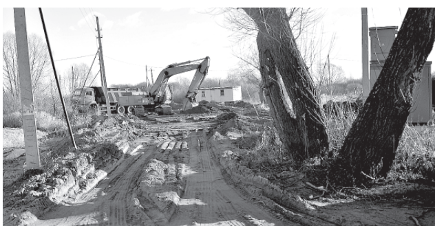
Выезд на Кардовского: здесь работы только начались. Видно, что объездная дорога будет совсем не широкой...
