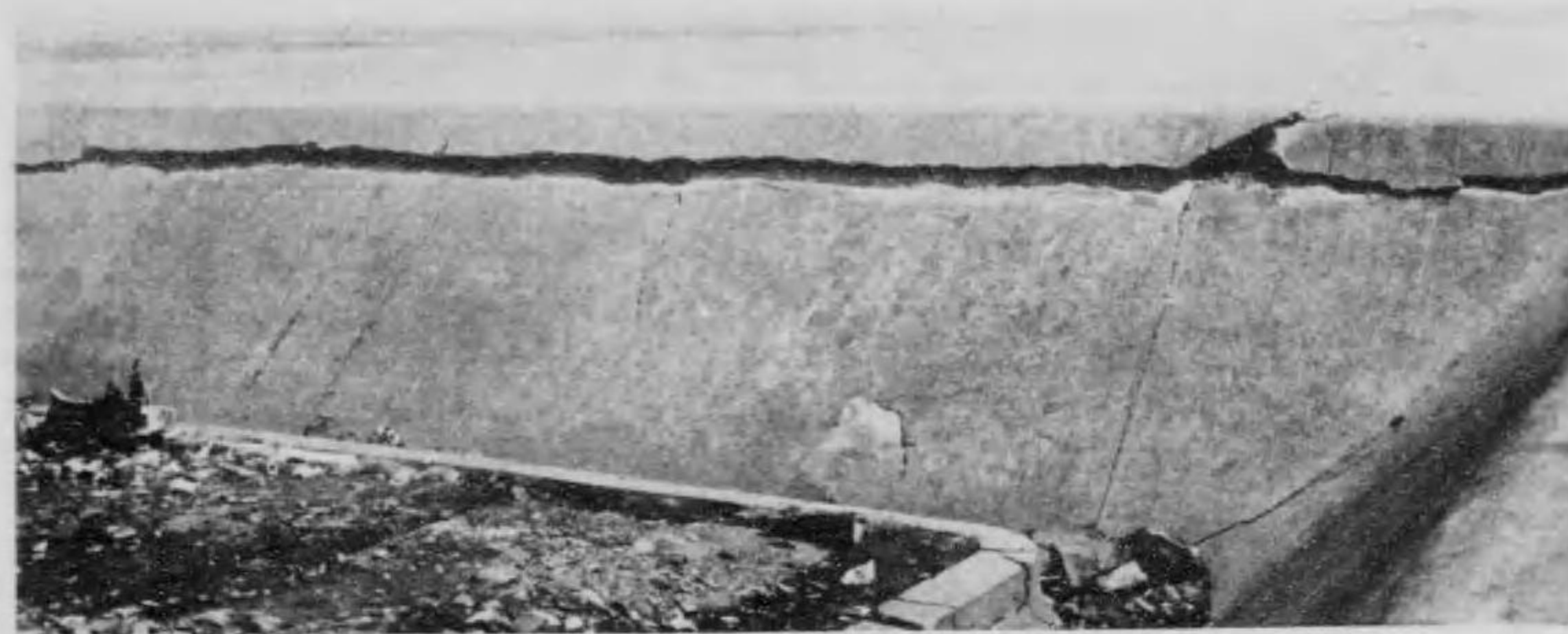
海面 (平久町及洲崎方面) 深川區洲崎辨天町海面堤防開門附近(其二)(背面)
