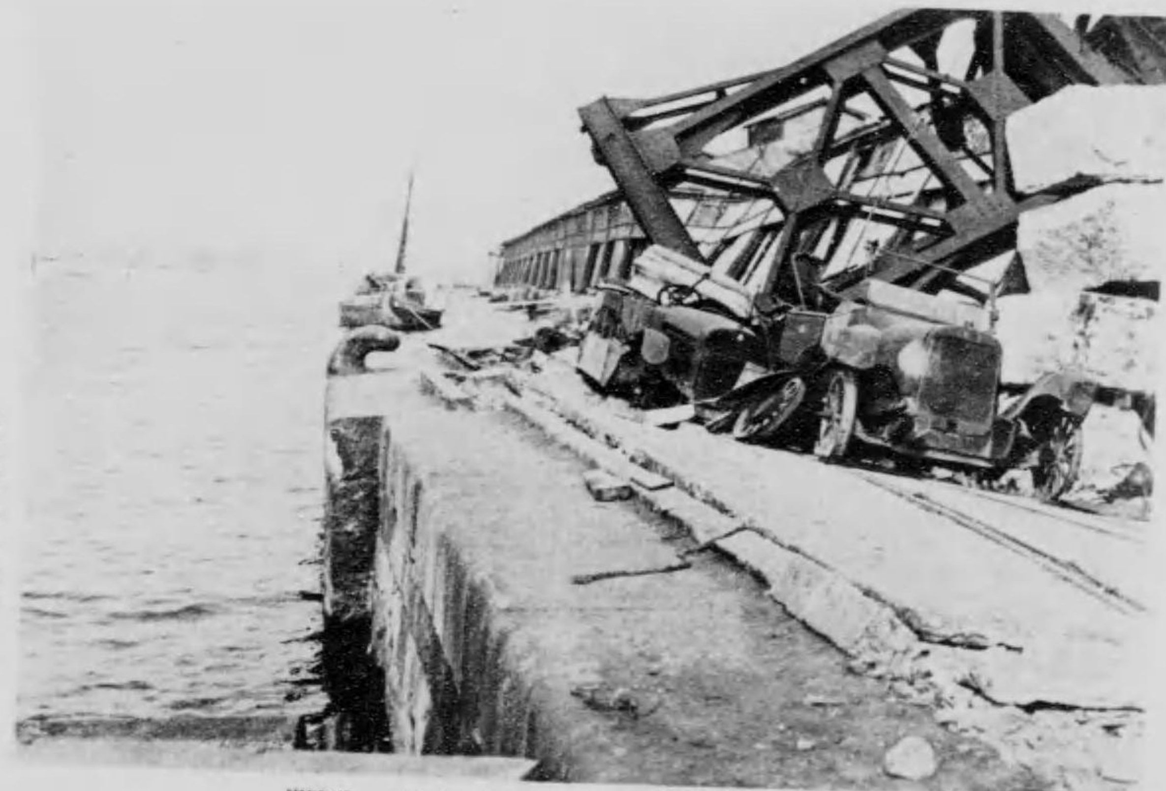
横濱港 第九號乃至第十一號岸壁の破壊
