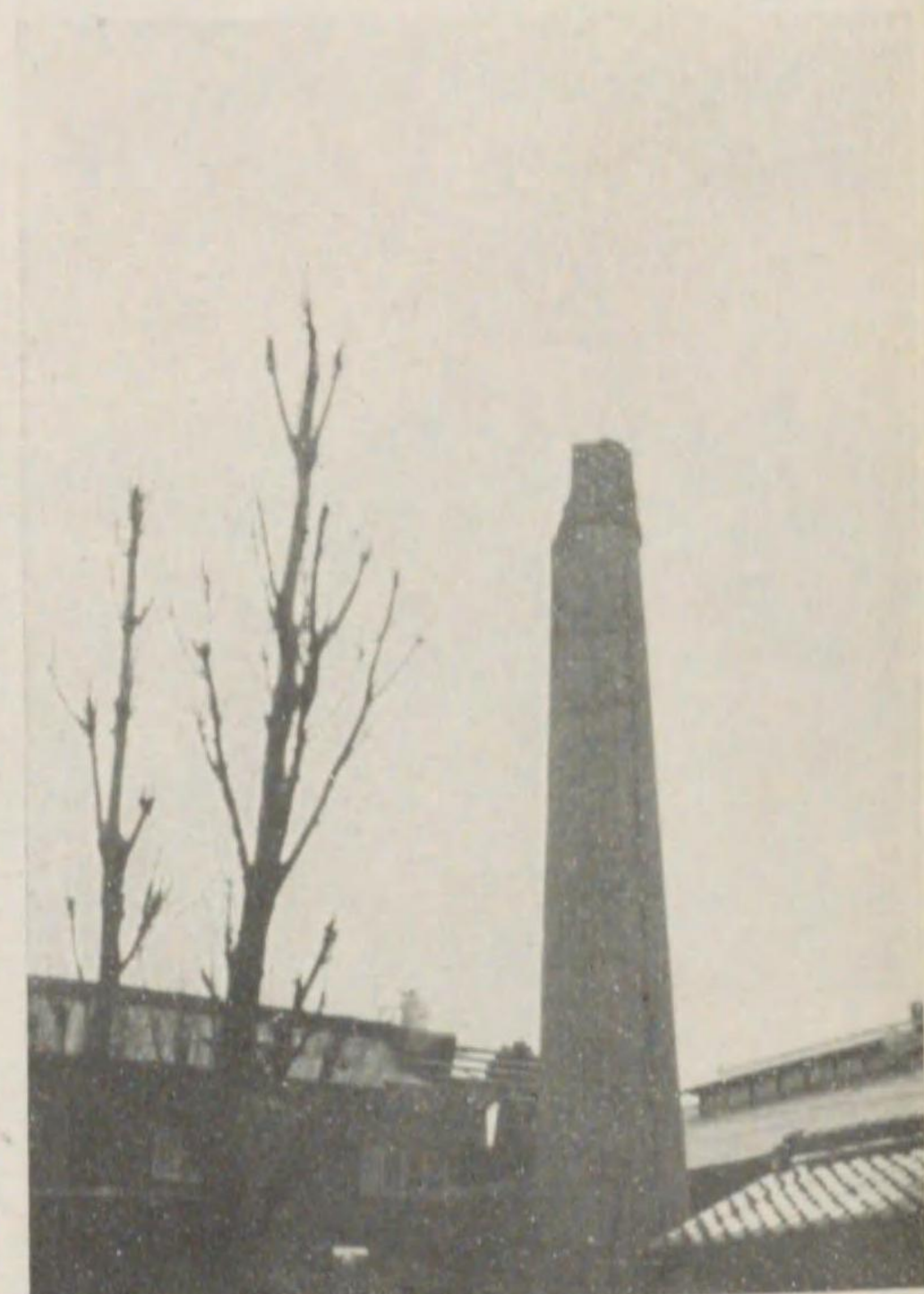
4) 奈良縣磯城郡川西村梅戸の膠工場の煙突(基部の徑2.4米、高さ約21米)上部より3米南西方へ崩落し隣接せる工場屋根を破り内部を破損す
