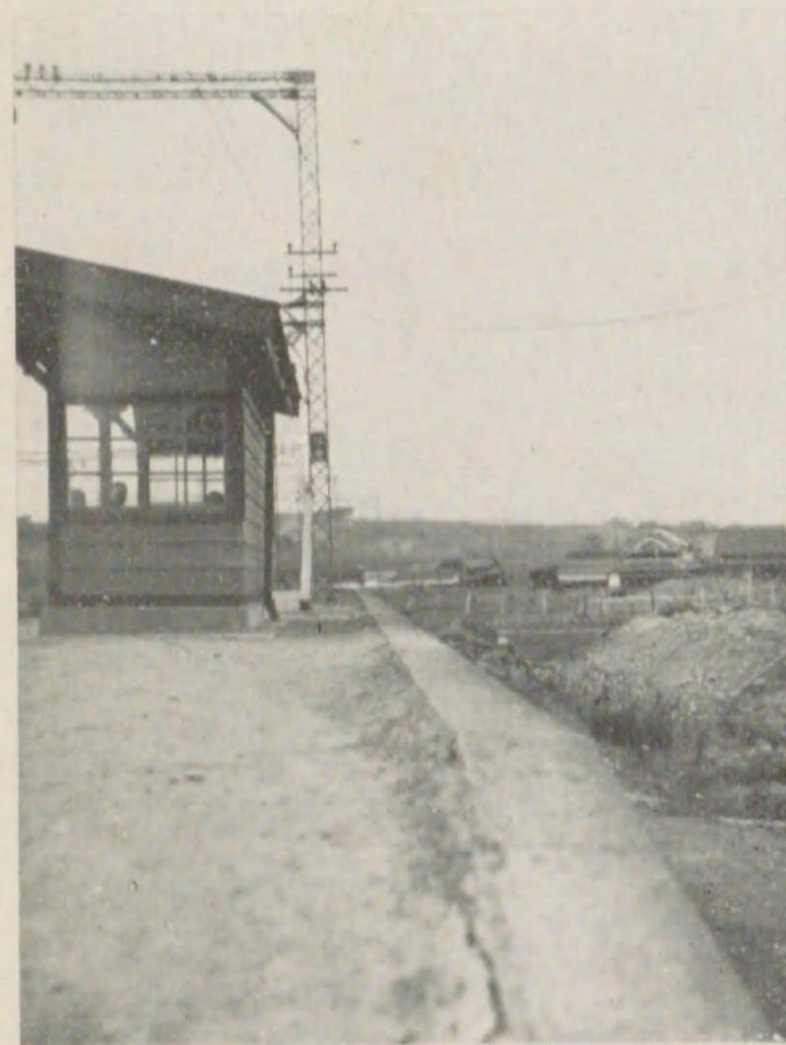
1) 大阪鐵道上大子驛ホームに龜裂を生じ内側沈下す
