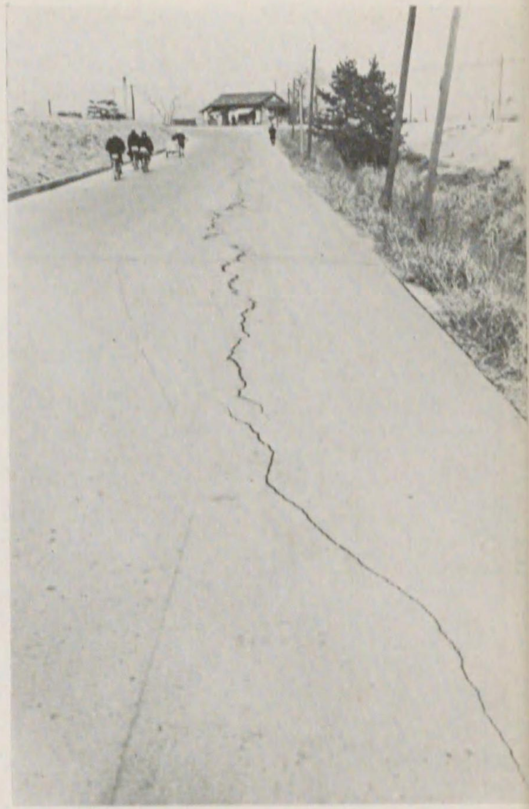
6) 大和川沿ひの奈良街道柏原道明寺間のアスファルト道路上の横の龜裂
