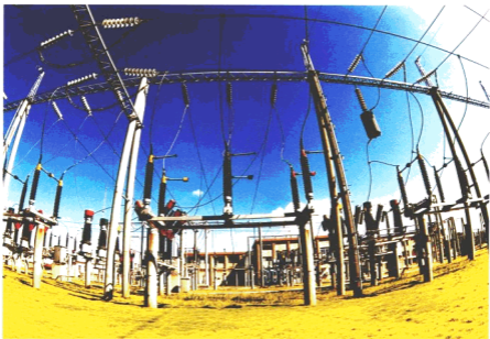
110kV变电站 Transformer Substation (110kV)
