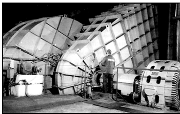
Вентилятор загального провітрювання ВЦД-31,5 (Росія).
