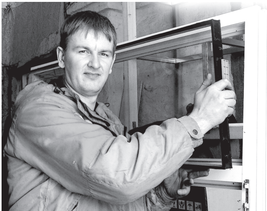
Сергей - специалист бригады по монтажу окон: во время выполнения заказа по установке новых окон в одной из квартир дома № 54 на улице Свободы
