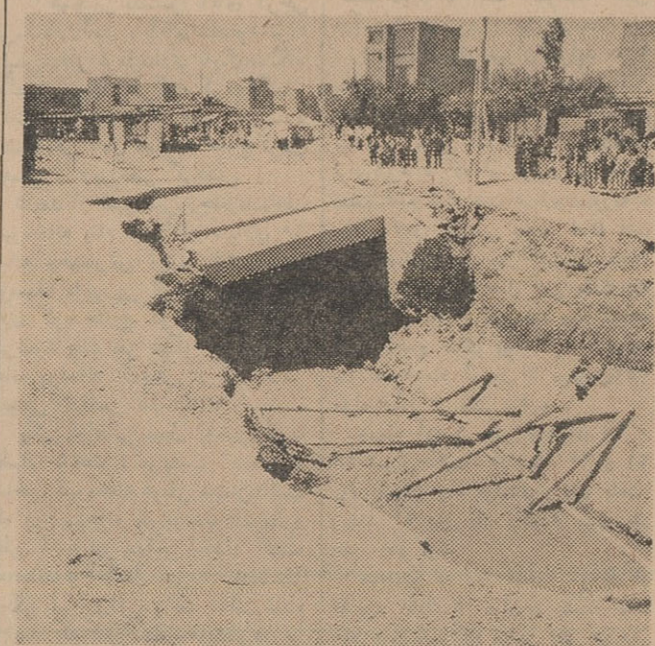
پل خیابان هاشمی فرونشست و ارتباط دو قسمت خیابان قطع شد
