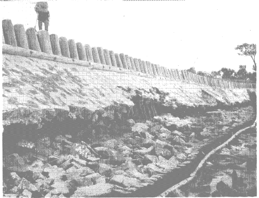
育字段膠砌椿石工程被冲損情形
