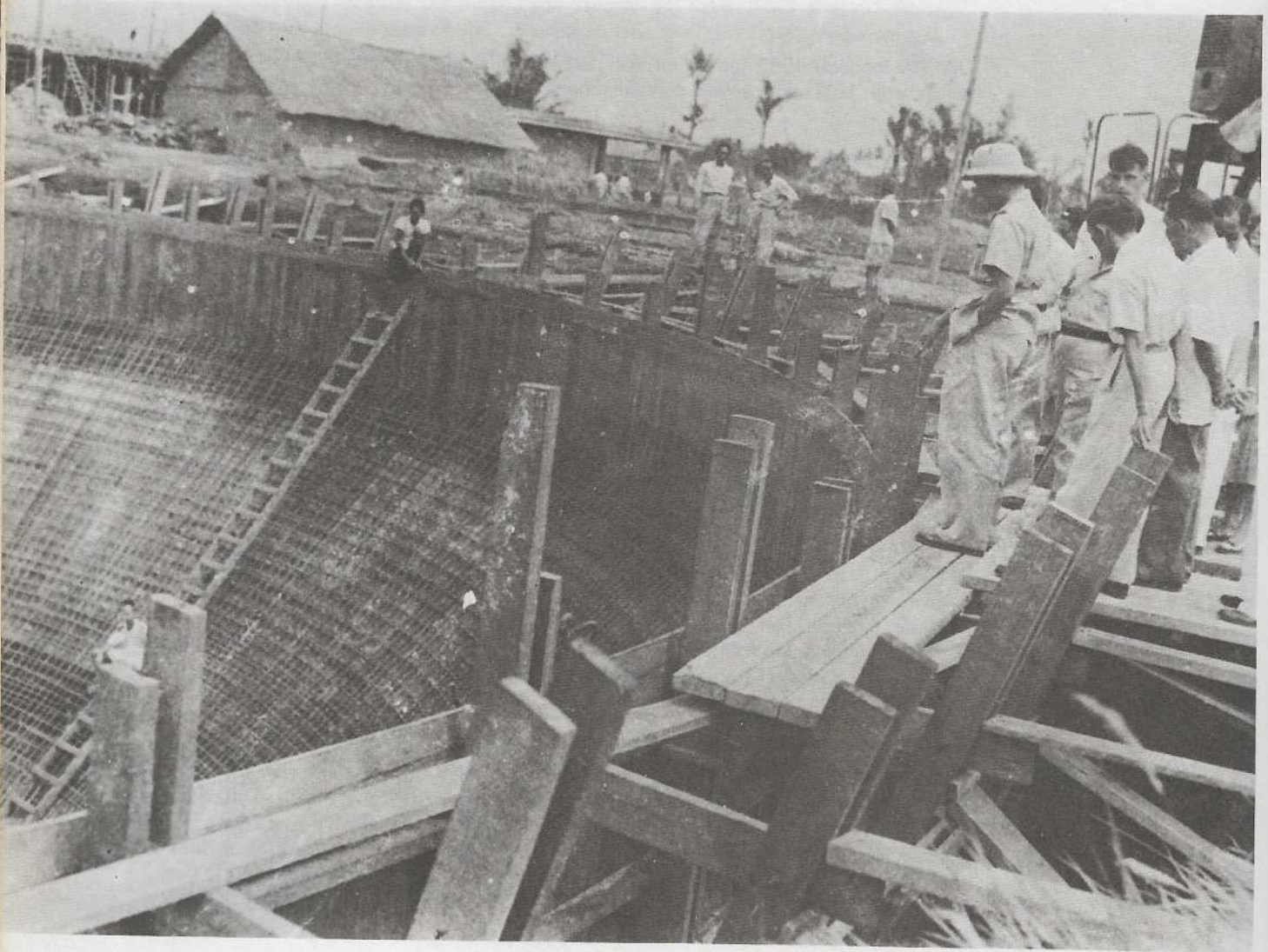
Para pekerja sedang melakukan inspeksi dan pengukuran di lokasi proyek. Mereka menggunakan alat-alat berat dan peralatan konstruksi untuk menyelesaikan pekerjaan.
