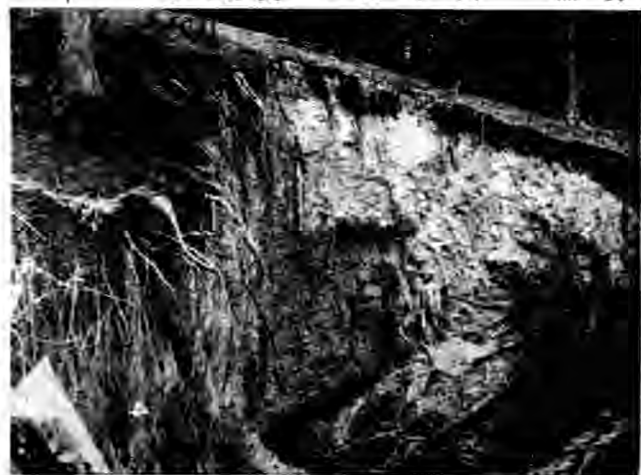
第一百八十七圖 土壩之旁溢道被冲刷後之情況。此溢道曾僅以植物保護之。
