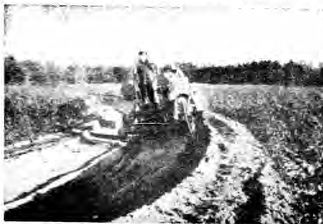
第一百七圖 兩輪，四五〇〇磅，十英尺葉片整平機，以三十五至四十馬力曳引機拖之，於砂質壤土上，自上坡築階情況
