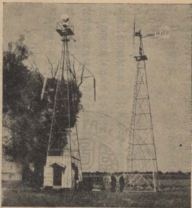
第五十一圖 24吋之標燈及風力推動之發電機
