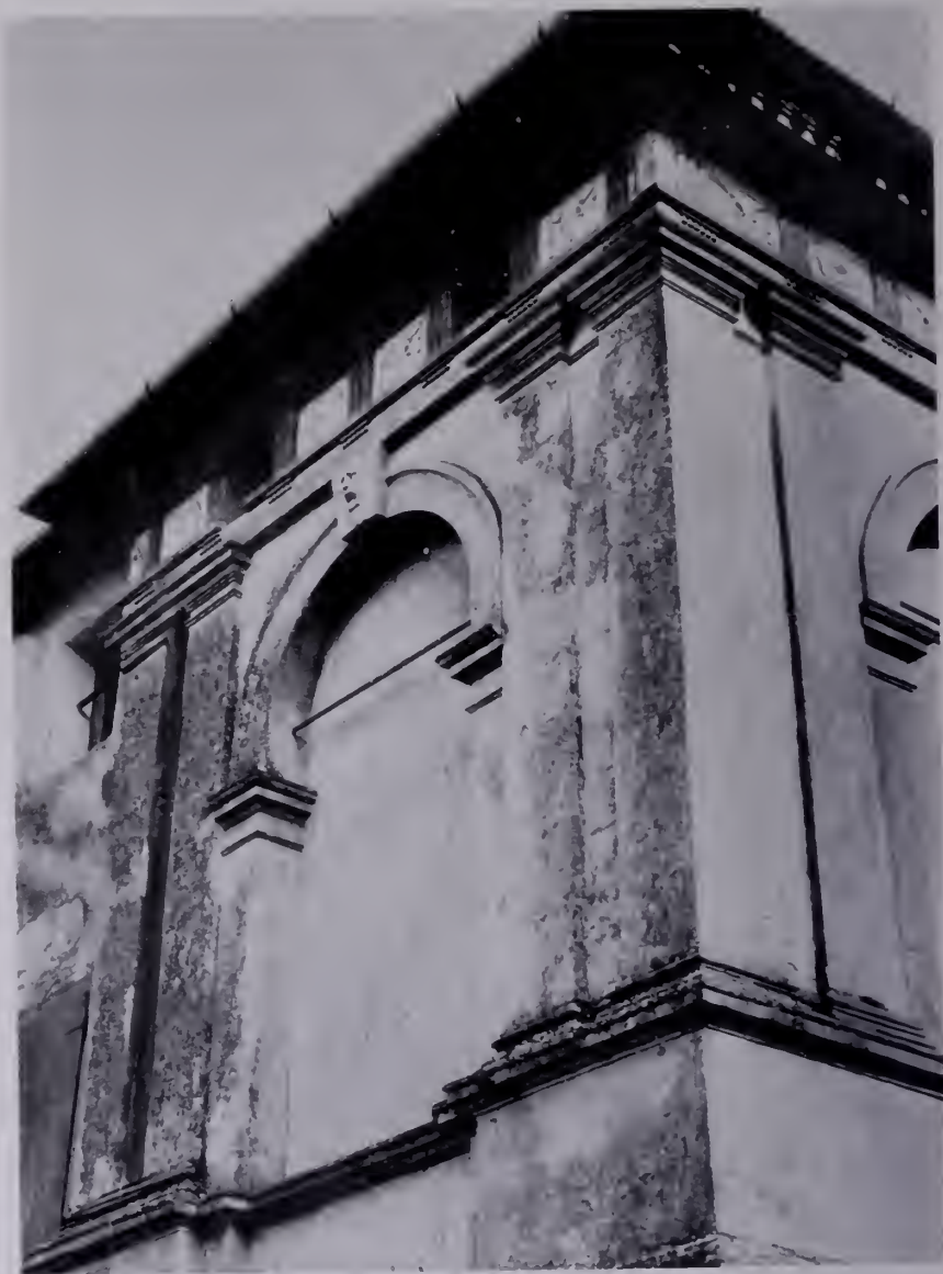
Fig. 33 — Luvigliano (Padova), Palazzo vescovile. Falcoatto e Alvise Cornaro: Particolare del fianco rimasto incompiuto. (Fot. Ceccato).
