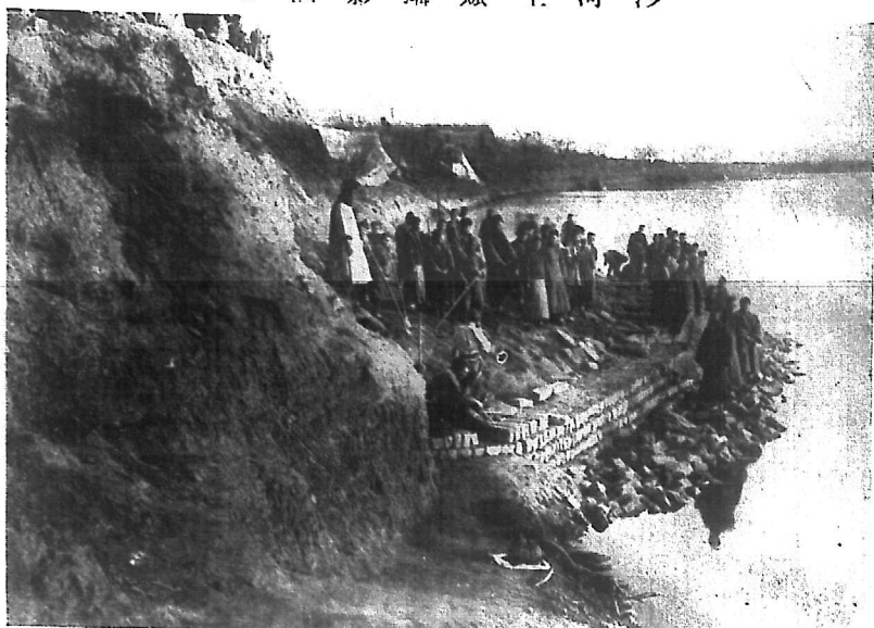
第二階段修築崔嶺第二大道人工壩暨石護岸工程進行狀況
