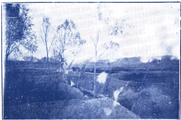
勝泉下游渠道淤塞情形
