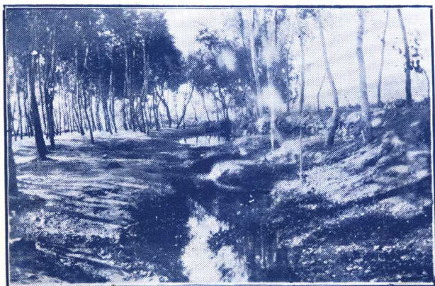
房山西甘池泉渠道梗塞情形
