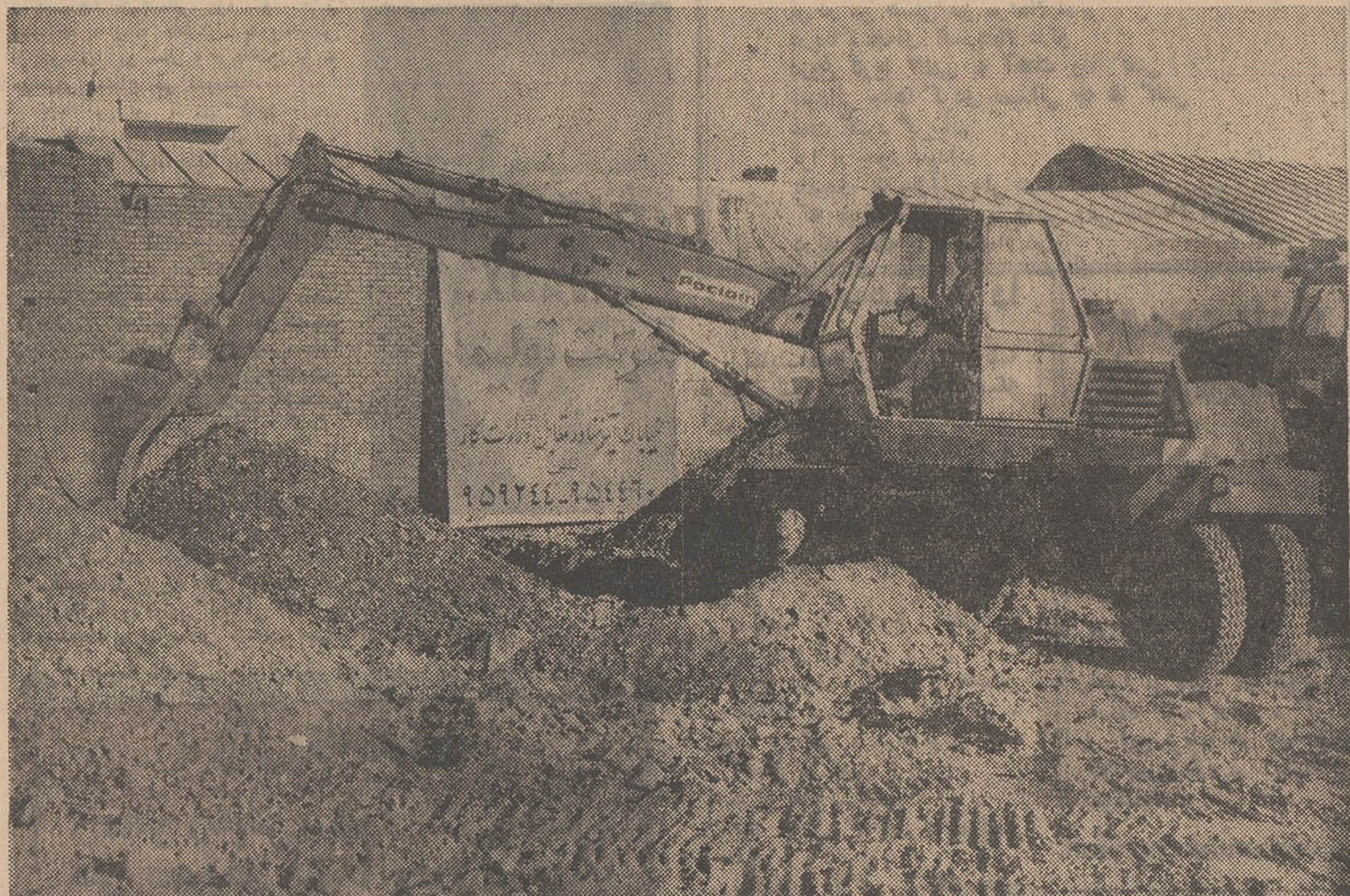
بیل هیدرولیکی پوکلین ساخت کارخانه تولیما، يك ماشین بر نظیر در نوع خود است و این بیل قادر است استوانه ای به عمق نه متر و حجم هیجده متر مکعب تا چند صد متر مکعب را در اعماق زمین پی کنی و حفاری و خاکبرداری نماید. این بیل با بلند کردن نه تن برتری ماشین های ساخت سوئد را ثابت کرد.
