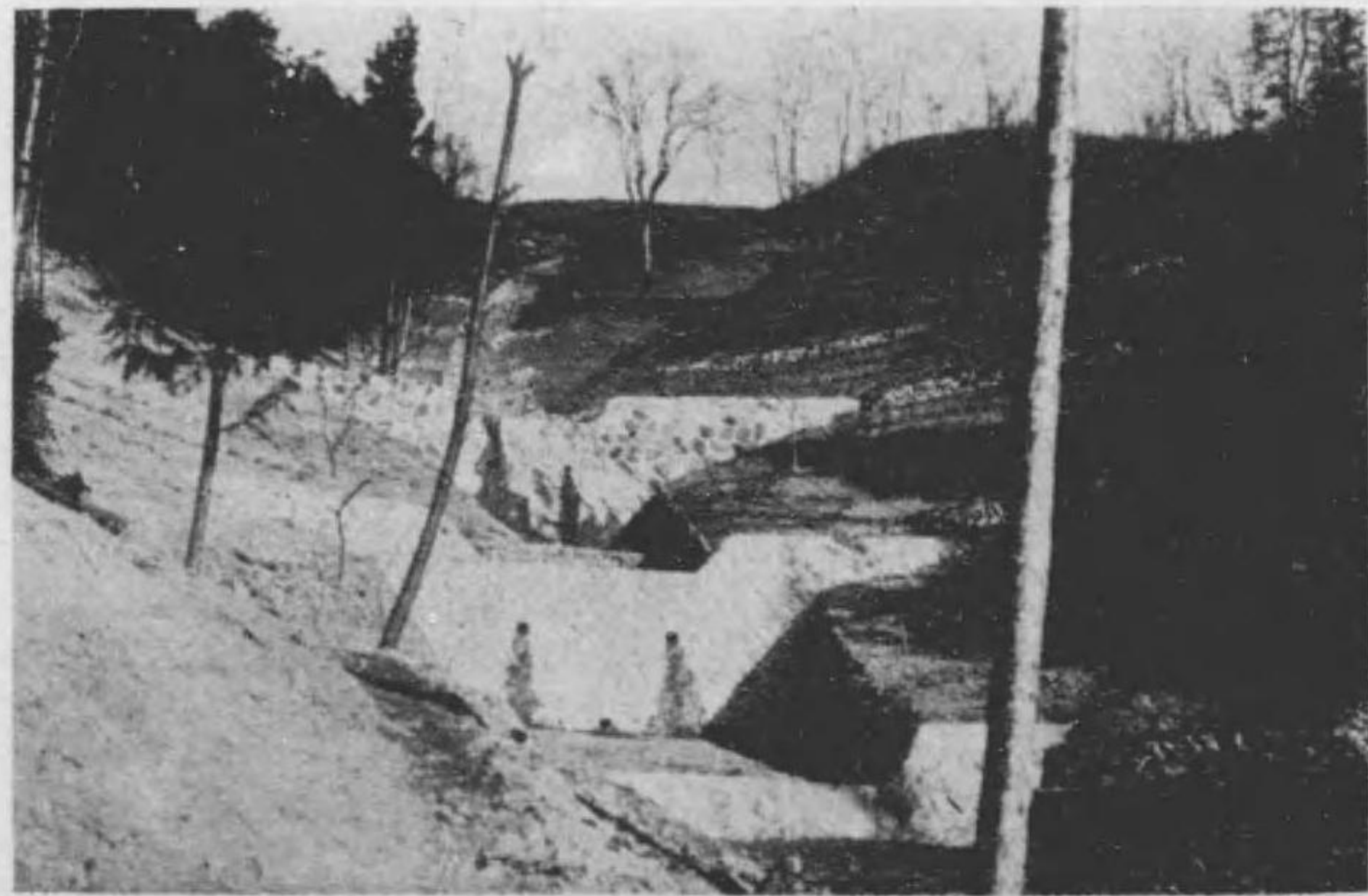
多野郡中里村大字魚尾所在荒廢林地復舊工事 施行後の状況にして、直下に魚尾部落を控へ 工事施行前は區域内一帯に地辻地層とす。 工事施行 昭和五、六年度 施業面積 一町歩
