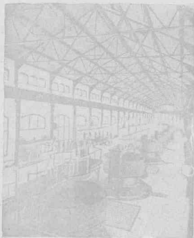
亞西拉瀑布之水力發電廠內景。電機室中有一列七座交流發電機，每座5000馬力。巨大的水輪機裝在地窖下數十呎之深坑內，用粗大直立的鋼軸直聯於發電機。水輪機在水平的方向內轉動時，上面的發電機也跟著在水平的方向內轉動。
