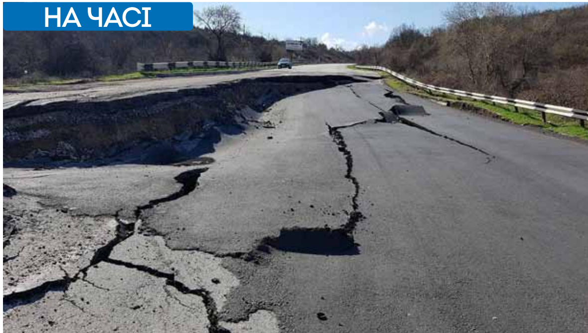
Провали на автошляху Севастополь-Сімферополь. Квітень 2017 р.
