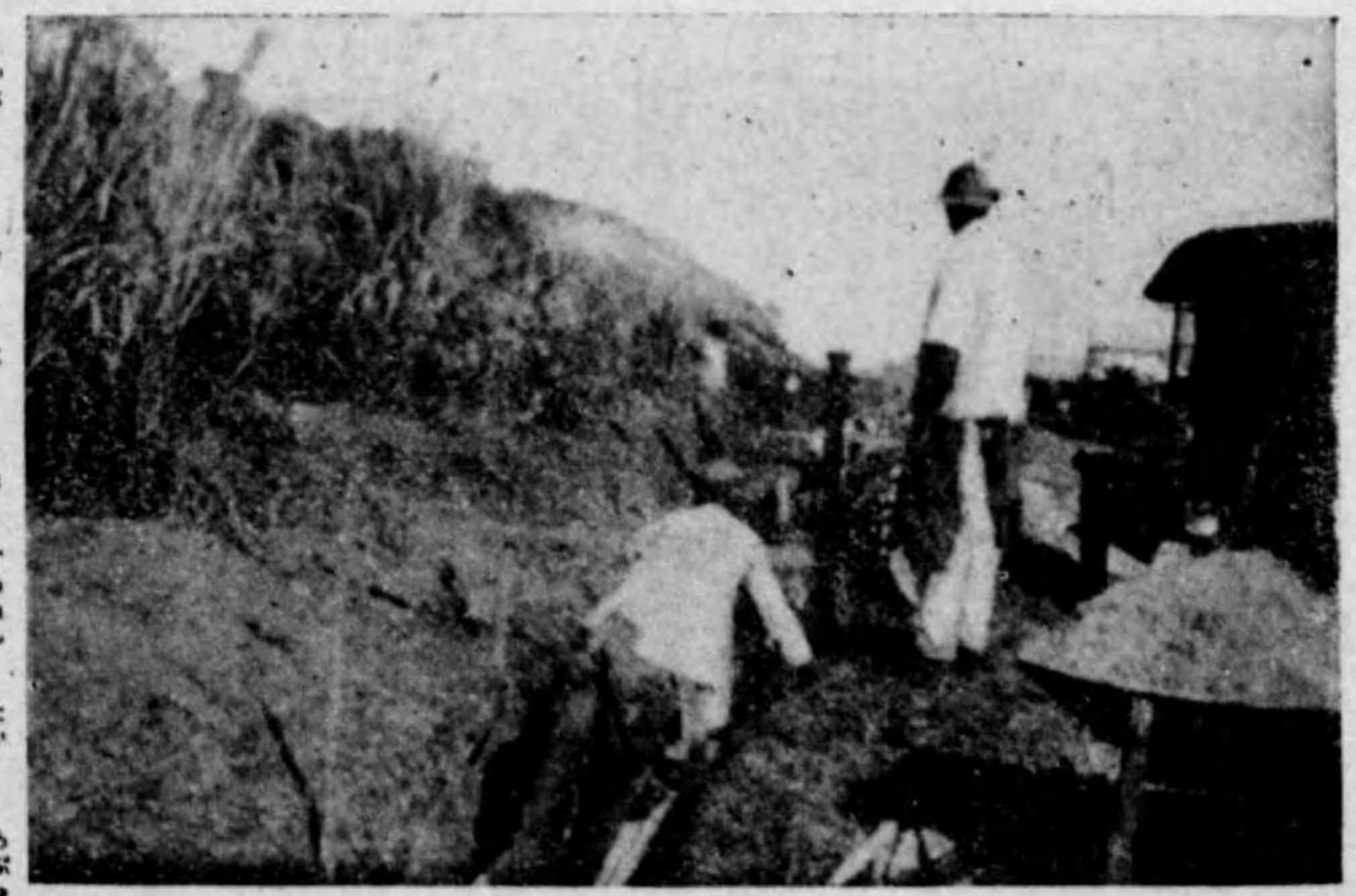
埋立てられた沼澤の縁に残つた溝の、まだ排水されない所は重油を撒布し、葦に似た草の水面の高さに油
