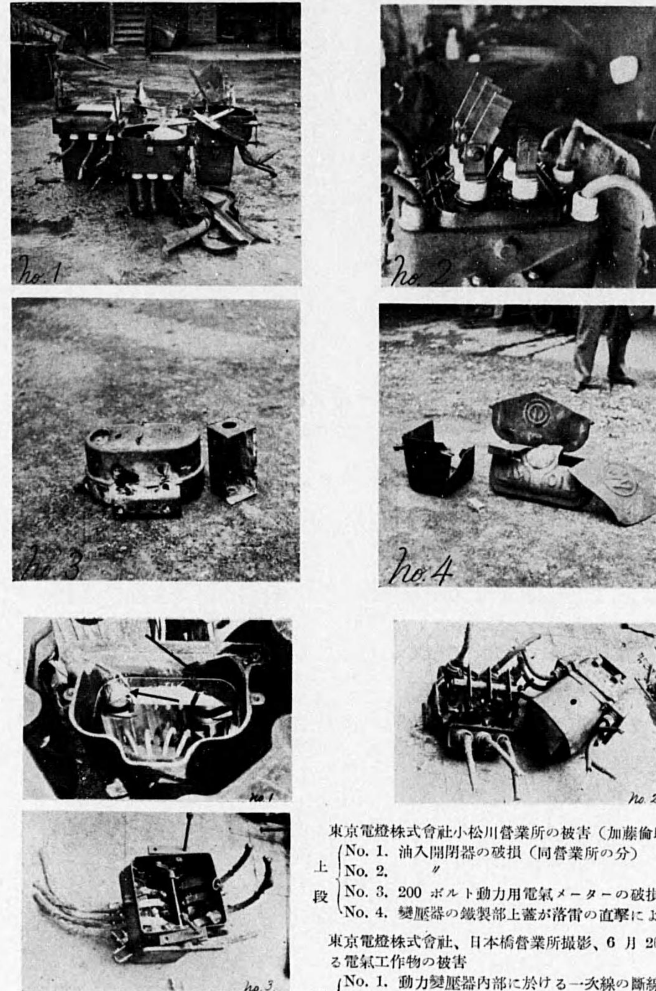
第73圖 電氣工作物の被害寫眞
