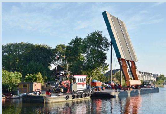
Figuur 29: Ponton met brugdeel arriveert onder leiding van sleep-/duwboten in Alphen. (Foto: kraanbedrijf)
