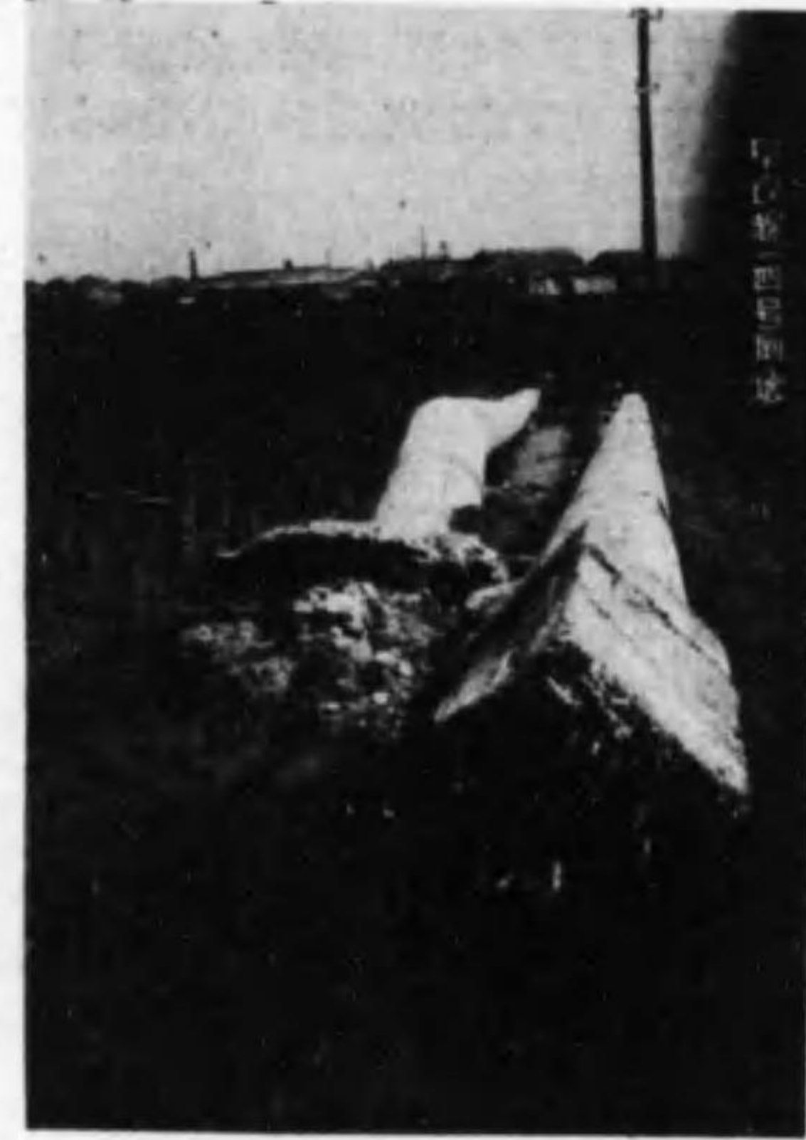
第27圖 昭和5年九州區域水害狀況 鐵筋コンクリート柱の倒壊
