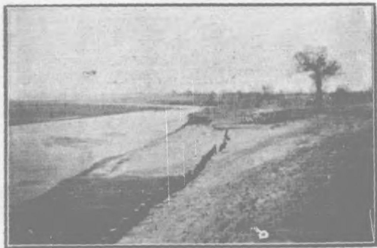
永定河北三段龍尾壩及土壩經凌汛塌場後殘跡
