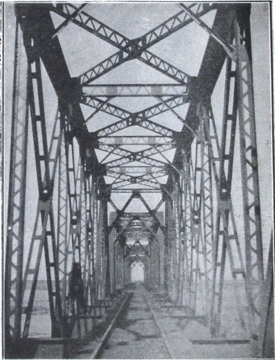
Puente de 200 metros de luz sobre el arroyo Saladillo— Rama! de Beguirie al Azul.
