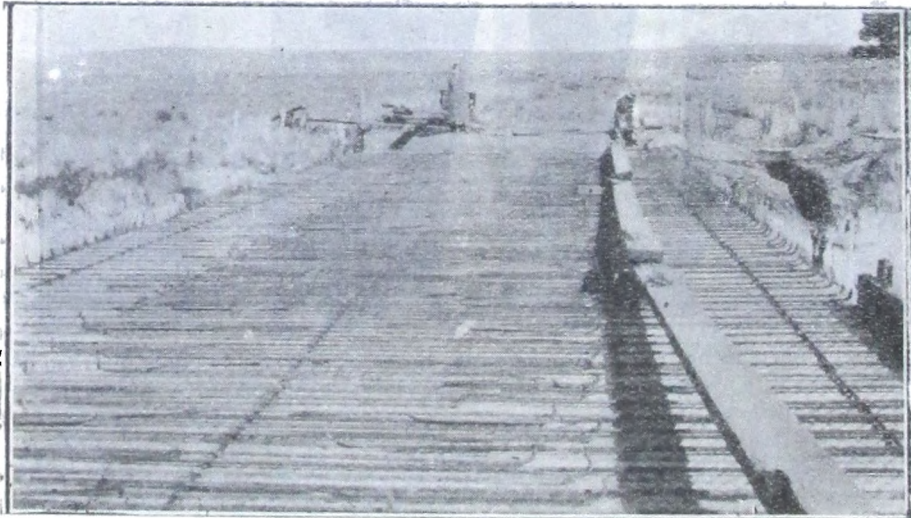
Armaduras de la loza del puente sobre el Napostá, en su cruce con el camino de Tornquist a Cabildo, en García del Río.
