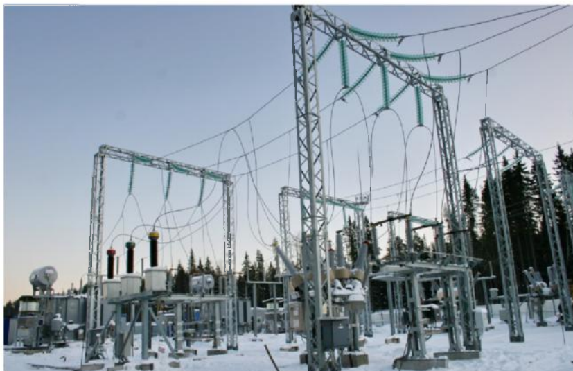
Новая подстанция «Логмозеро»
