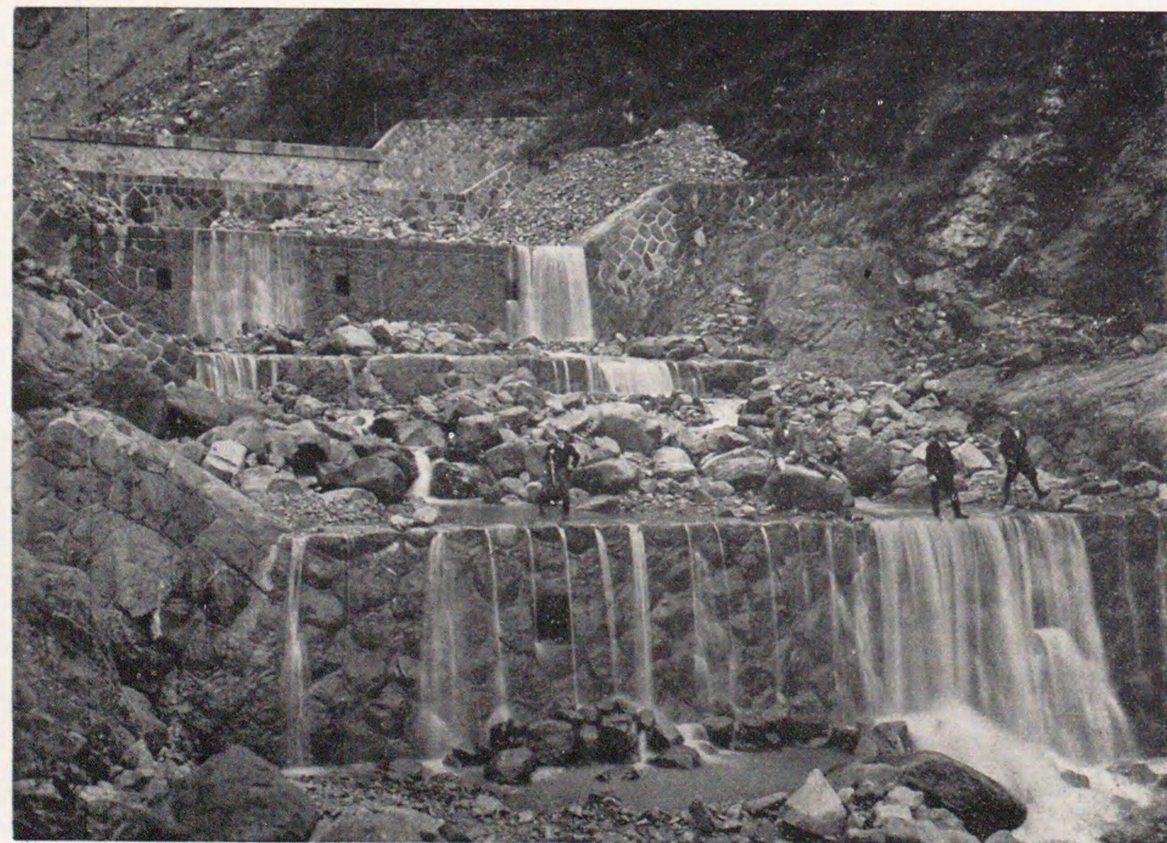
石川縣能美郡白峰村手取川上流柳谷堰堤により崩壊防止の狀況 (昭和八年)
