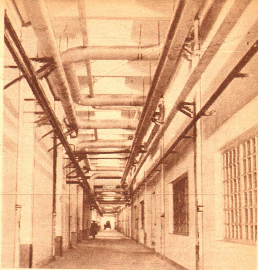
25 kilómetros de caños cruzan la fábrica. Este pasillo tiene 270 metros. Diariamente atraviesan la fábrica 12 millones de litros de agua...
