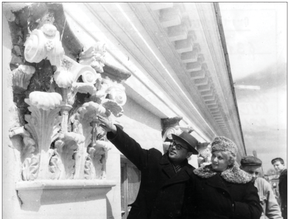
Архітектор Петропавловський В. П., засл. будівельник УРСР Алмазова С. Д. оглядають якість виконаних робіт з відновлення театру ім. А. Луначарського. 1957 р. Фото Акуленка І. Державний архів міста Севастополя, фонд фотодокументів, од. зб. 0-6311.
