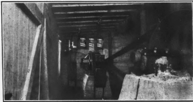
FIG. 5. INTERIOR SYDNEY FAN HOUSE
