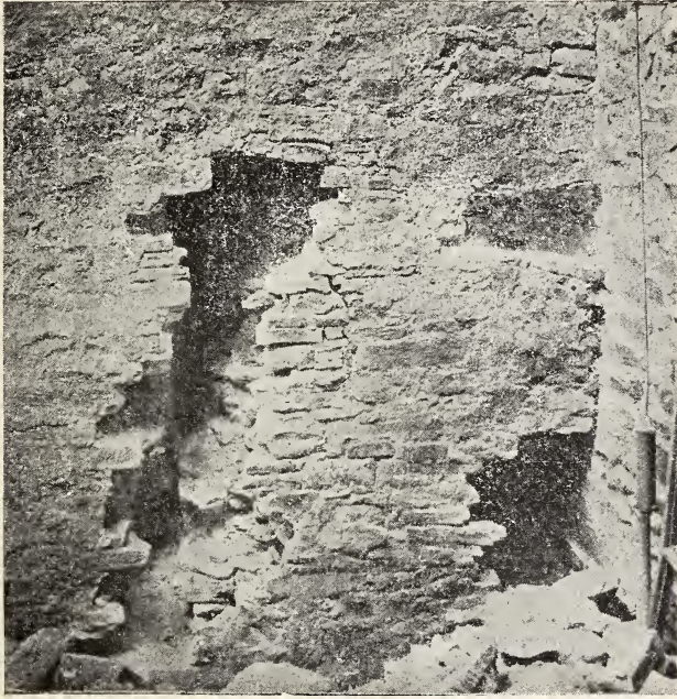
Fig. 227. Aufgedeckte Teile der ursprünglichen Vorhalle und des Paradieses des 11. Jahrhunderts. Östliches Stück der südlichen Außenwand.
