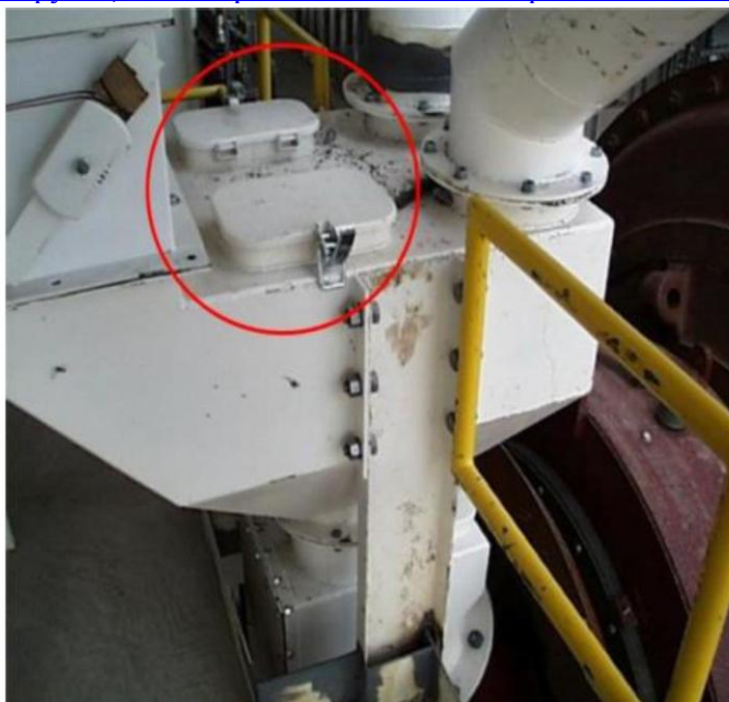
Рис. 4.14. Люки для осмотра и доступа расположены на верхней горизонтальной поверхности кожуха места перегрузки, так что риск высыпания материала минимален. Figure 4.14. Sampling doors located on top of a collection/transfer point to prevent leakage.
