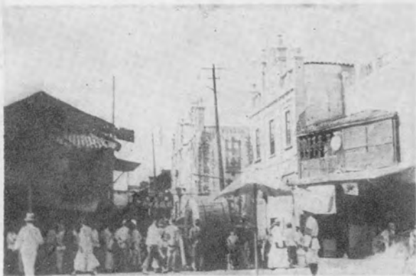
中山路戊子牌口先將 300 對鎖裝電纜盤架起預備開盤設放情形
