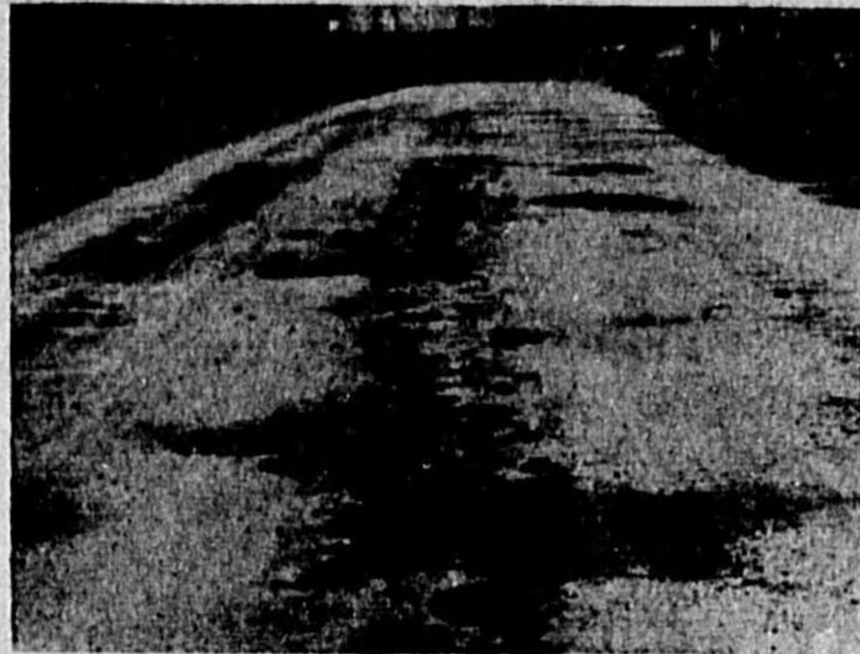
寫眞-4 アスファルト處理道 安定材混合不良に依る破壊状況
