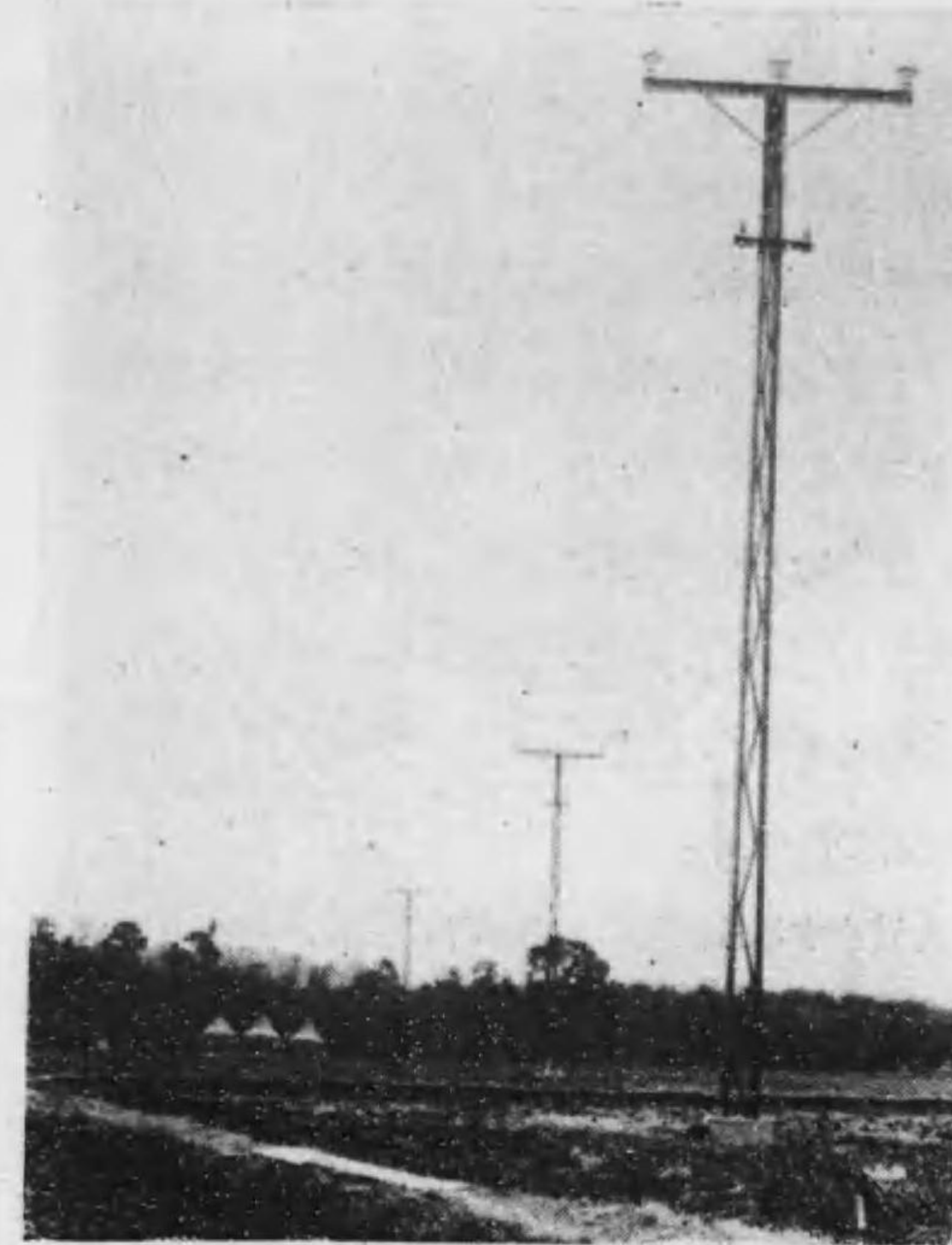
第31圖 其2 ベーツ式鐵柱 (22 000 ヴォルト送電線路ニ使用セル實況)
