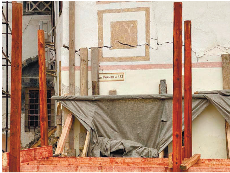
Тріщини на стінах Графського корпусу. 7-8 лютого 2022 року.
