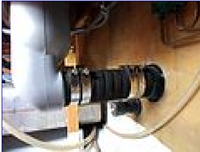
Échappement traversant la cloison étanche arrière
