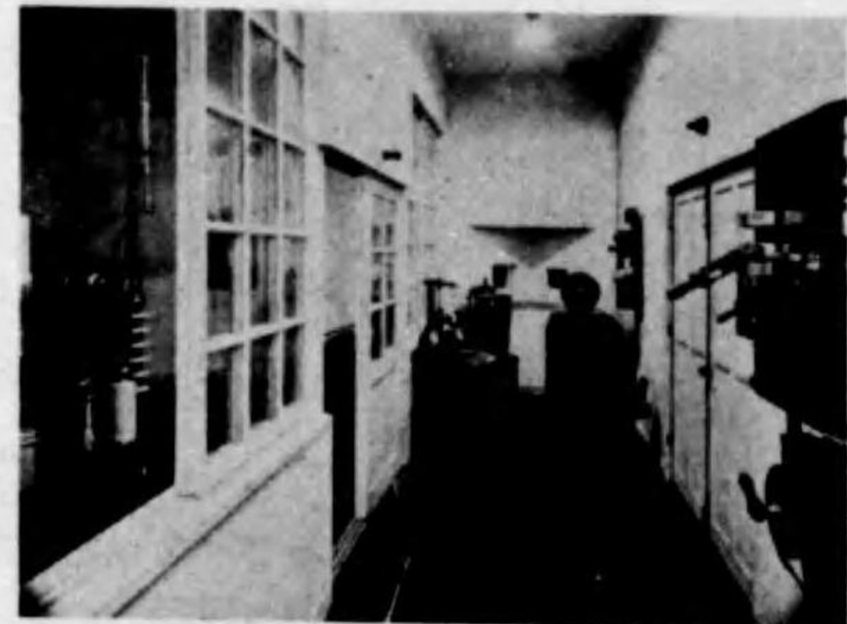
第5圖 制御室の一部
